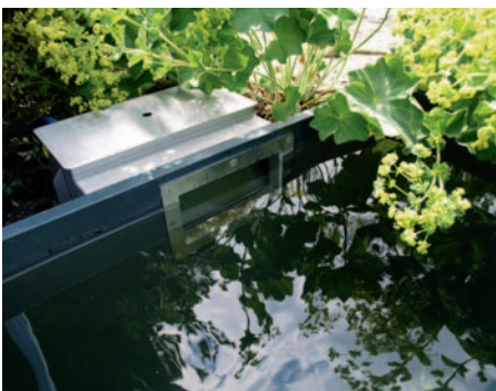
Skimmer und fertige Anlage (Bild rechts)
