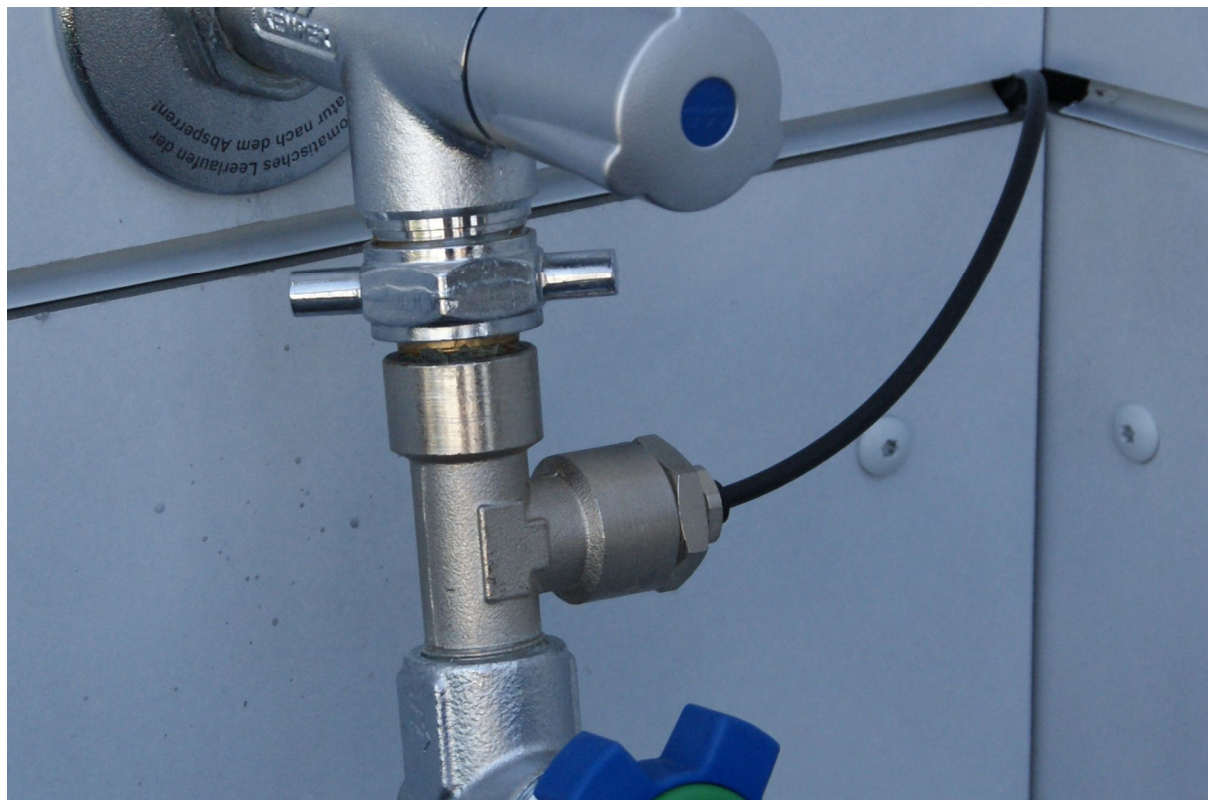
Bild 1: Anschluss mit Abzweiger 3/4" IG, mit Handrad, Raccord und Siebfilter. Zuleitung unter Fassade verlegt.
