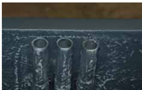
Rohre als Durchführungen für Elektroka- bel.
