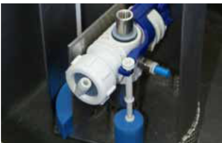
Der Bewässerungsautomat im [zur Darstellung aufgetrennten] Schacht .
