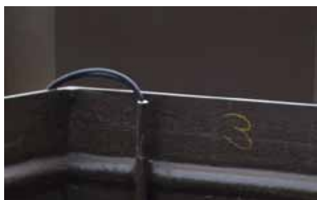
Gerades Rohr [schmal] mit mehreren Kabeln.
