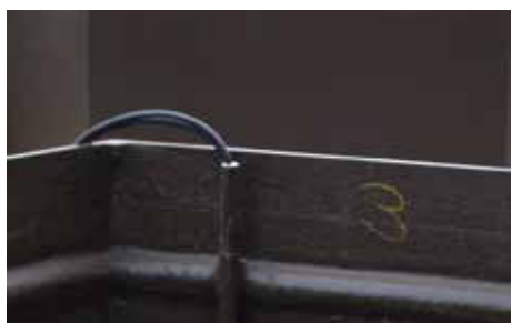
Gerades Rohr [schmal] mit mehreren Kabeln.
