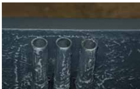
Rohre als Durchführungen für Elektroka- bel.
