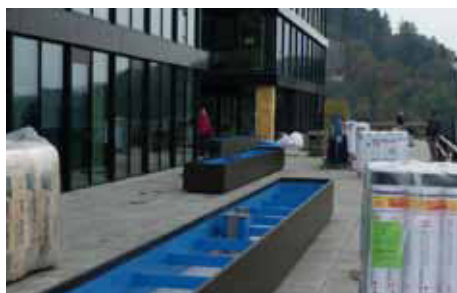
Elektroschacht, mit Deckel [Mitte]. In diesen Schacht wurden Leitungen von unten eingeführt und Steckdosen für die Beleuchtung angebracht.
