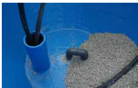
Gerades Rohr [breit] mit mehreren Kabeln.
