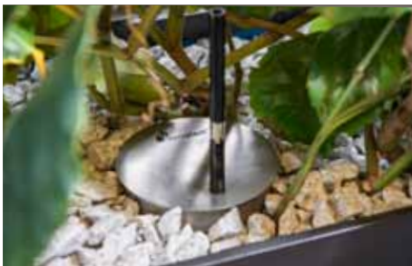
Der Multifunktionsschacht mit Deckel und Wasserstandsanzeige.
