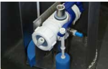
Der Bewässerungsautomat im [zur Darstellung aufgetrennten] Schacht .
